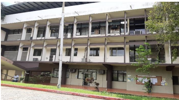
Figura 3. Edificio de la Facultad de Economía. Se pueden apreciar los quebra-soles y la carencia de ornamentación. Fuente: los autores.
