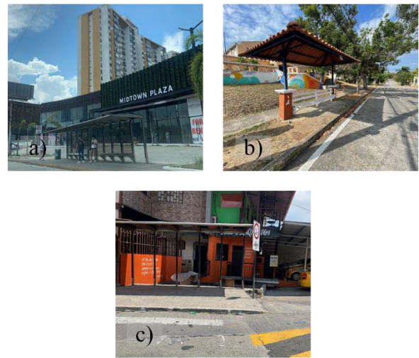
Figura 8. a) Parada de bus en condición de buen estado según la escala de Likert localizada en el corregimiento de Victoriano Lorenzo, b) parada de bus en condición de estado regular según la escala de Likert localizada en el corregimiento de José Domingo Espinar, c) parada de bus en condición de mal estado según la escala de Likert localizada en el corregimiento de Belisario Frías.
