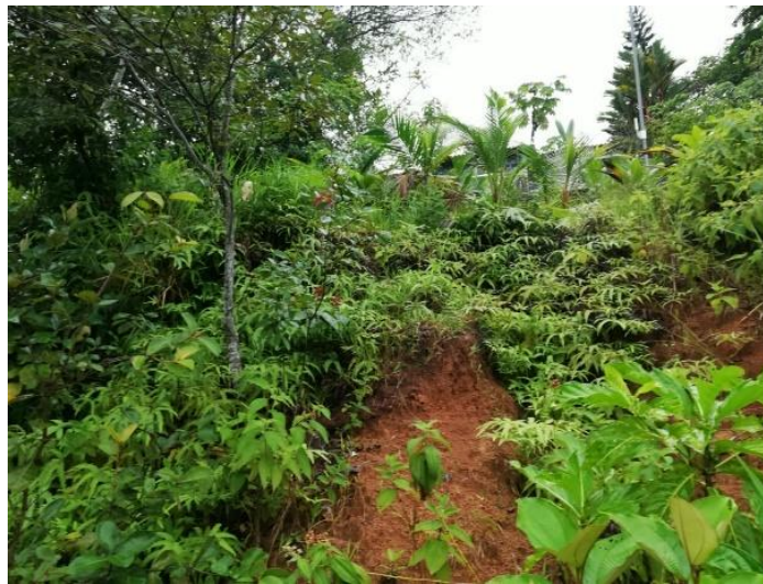
Figura 6. Falla local existente en el Talud
