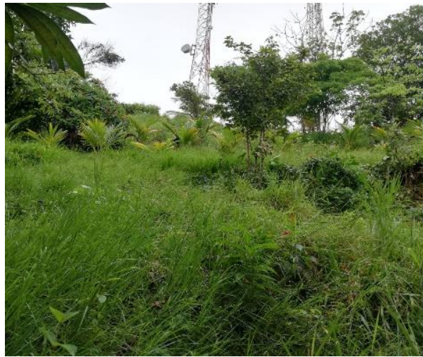
Figura 11. Sitio a Realizar Cambios en la Topografía Nota: Este es uno de los sitios propuestos dentro de Talud a estabilizar ya que el mismo a presentado deslizamientos locales que han sido cubiertos por la vegetación
