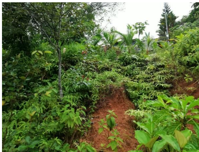
Figura 6. Falla local existente en el Talud
