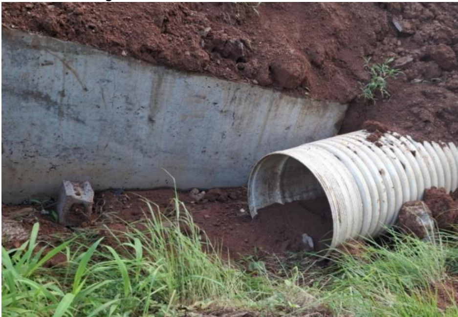
Figura 8. Salida de desagüe
