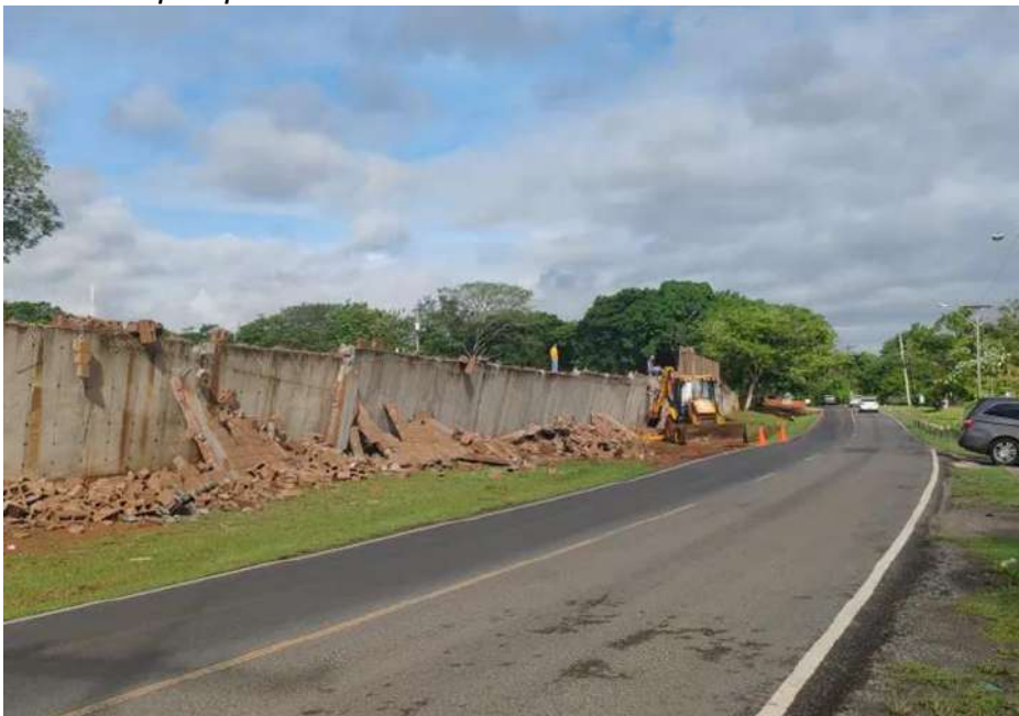
Figura 4. Muro colapsa por lluvia en La Chorrera
