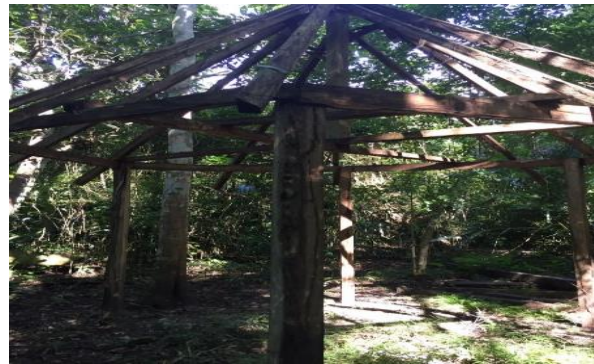
Figura 9. Construcción de cabaña para descanso durante los recorridos. Fuente: fotos tomada por la autora/investigadora
