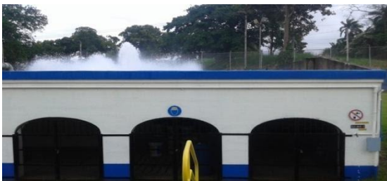
Figura 3 a. Toma de Agua de Agua Cruda (AC)
