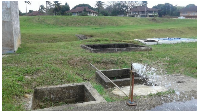
Figura 4c. Toma de agua – Medidor de Sherman (MSHE)
