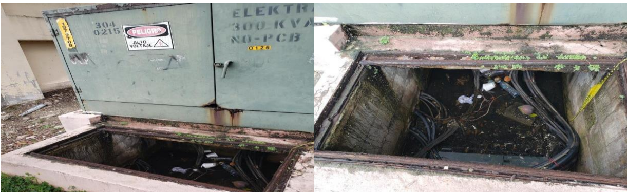
Figura 3b. Cajilla eléctrica sin seguridad dentro de las áreas verdes del Centro Regional Universitario de Colón.
