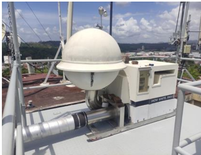
Fig.1. Vista de la aspiradora SNOW WHITE, SW, modelo JL-900 en la azotea del edificio de la rectoría.
